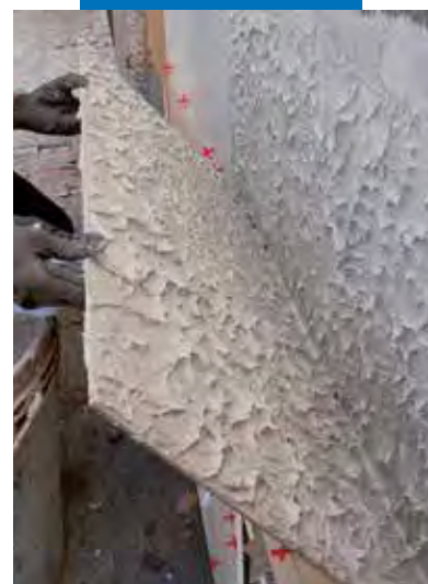
Verificarea dosului unei placi daca este complet acoperita cu adeziv la aplicarea pe o fatada la exterior
